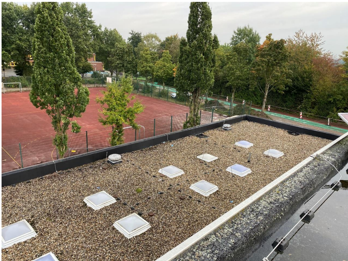
Zwei von drei Abluftdachventilatoren oberhalb des Umkleidenbereiches
